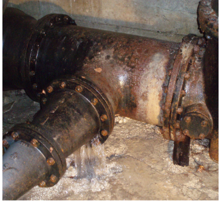
Durch Korrosion werden Leitungen schleichend zerstört.
